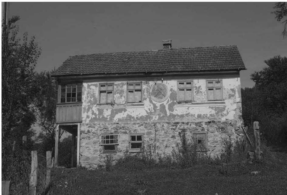
2. kép Leromlott állapotú bányászházak Verespatakon Photo 2 Run-down miner houses in Verespatak
