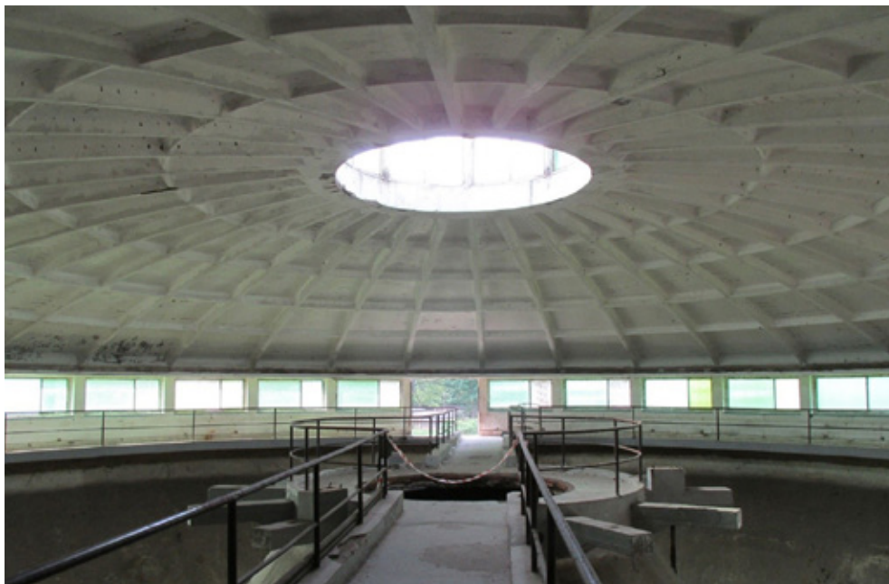
16. kép Budapest, Váci út, Vízisztítómű, derítőmedence kupolája. Fotó: Zsanda Zsolt
