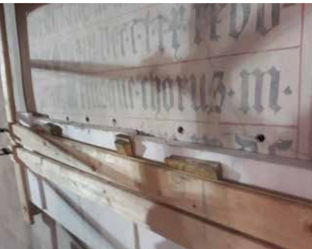
4. kép A szerkezet az elvált vakolat visszaszorításához
