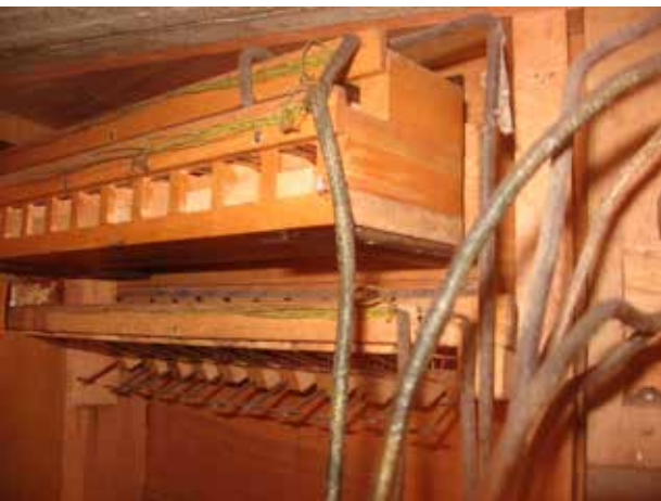
6. kép Az eredeti, vászonszigetelésű kábelezés
