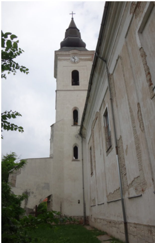
15. kép A torony délkelet felől nézve a templomhajó nagy felületeken vakolathiányos oldalhomlokzatával a homlokzat felújítási munkák előtt. Fotó: Bartos György, 2016
