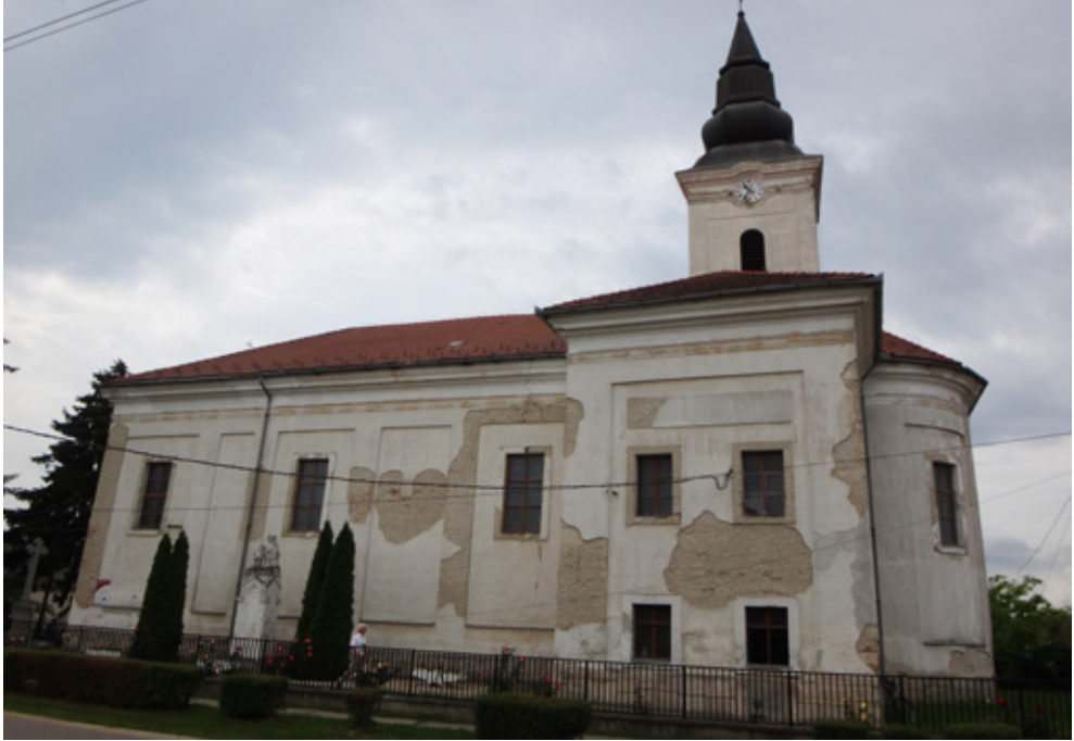
5. kép Az északkeleti oldalhomlokzat a felújítás előtt, nagy vakolathiányokkal. Fotó: Bartos György, 2016
