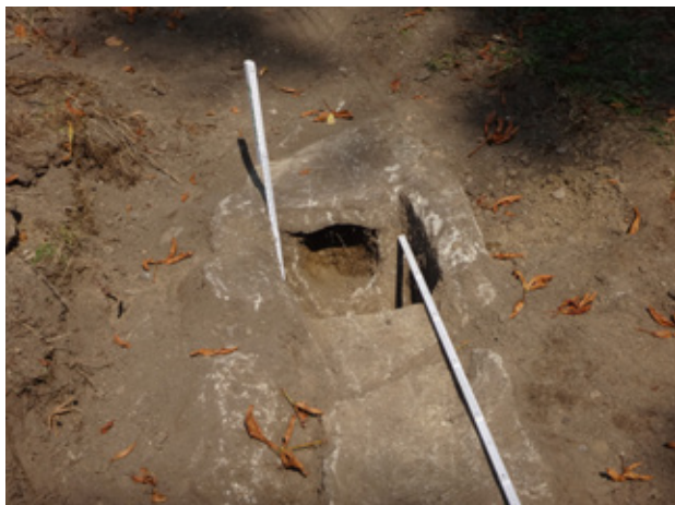
10. kép Az áteresz roncsolódott betonszerkezete. Fotó: a szerzők felvétele
