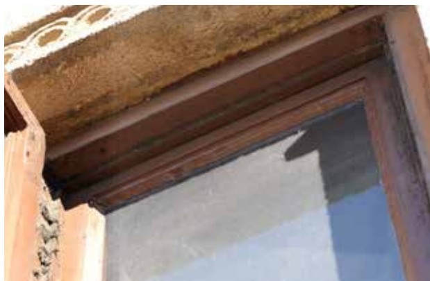
4. kép A két szárny közötti rész koszgyűjtő, az üvegek belső oldala piszkolódik, és mindez csak nagyon körülményesen tisztítható.
