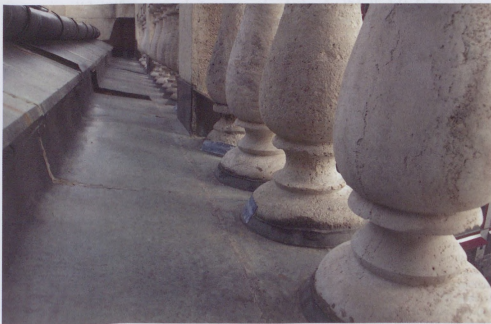
2. kép A homlokzati mellvéd balusztrádsora mögötti rész a felújítás előtt: a csapadék egy jelentős része a balusztrád-elemek között volt átvezetve. (dr. Birghoffer Péter)
