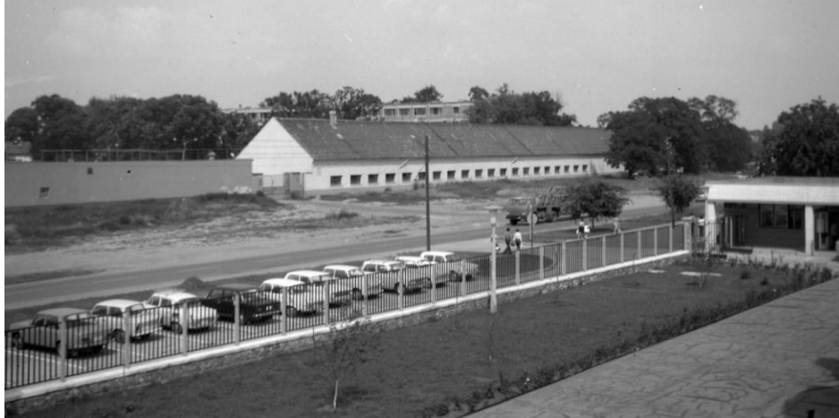
A méntelep déli oldali istállója 1975-ben. A háttérben a méntelep főépületének emeletráépítése folyik. (Mikrofilmtár)
