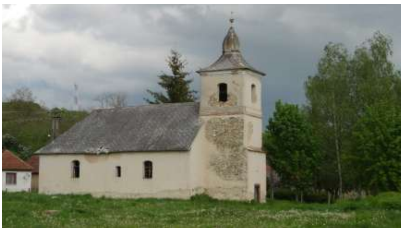
A leromlott állapotú református templom nyílászárók nélkül, megbontott tetőzettel Szakácsiban.
