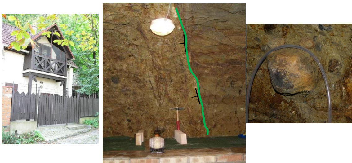
18. ábra: A tulajdonos feleségéről elnevezett Magdolna pince és borház (balra) a Felsősor 426 sz. alatt található. A pincét hosszirányban átszelő vető mentén eltérő kőzetek érintkeznek egymással (középen). A zöld vonaltól jobbra homokkő és bentonit, balra extraklasztos andezittufa található változóan elszínezve limonit-sínókkal és foltokkal. A pince extraklasztos andezittufájában nagyobb andezitblokkok is előfordulnak (jobbra).
