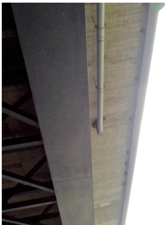
A hídon a hídszél betonpereme alatt és a csapadékvíz összefolyók csővezetékei körül található a legtöbb fészek
