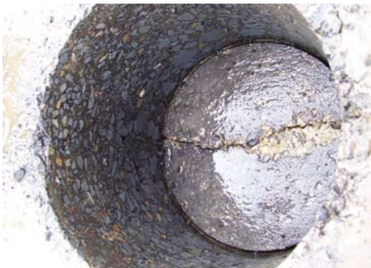
3. kép: Tengelyirányúan repedt cementtel stabilizált homokos kavics (telepen keverve), a 21-es sz. főút előzési szakaszának új kivitelezésű oldalán
