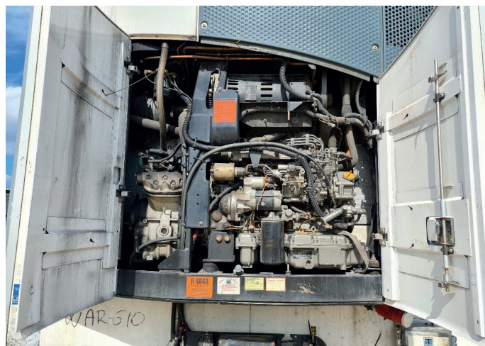
2. ábra: Thermo King hűtőrendszer és a beépített SLX motorház
