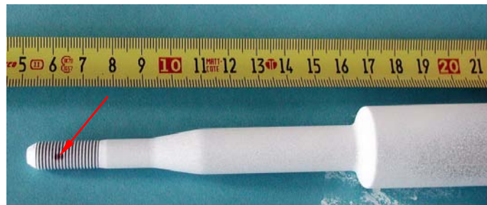
23. ábra: Repedés az olajbefecskendező menetes részén
