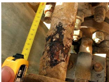
13. ábra: Korróziós fogások a fokozatközi hűtőnél
