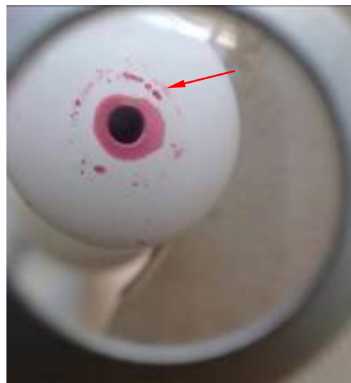
24. ábra: Repedés az olajbefecskendező tömítő felületén
