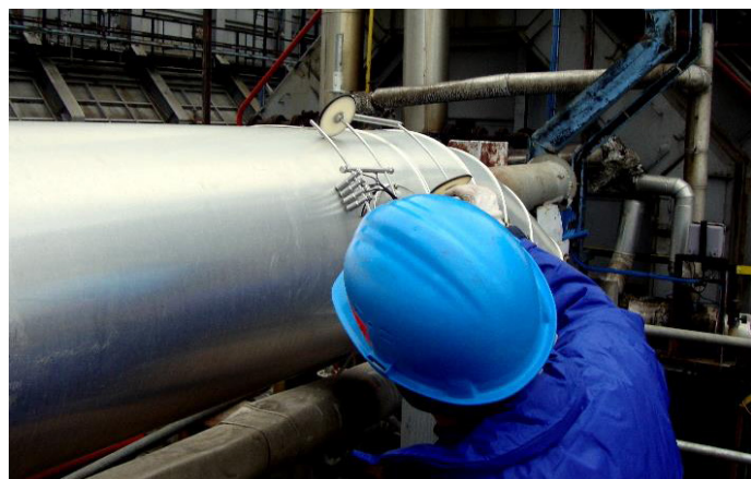
27. ábra: MMM vizsgálat szigetelésen keresztül
