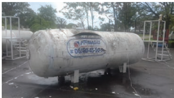
4. ábra: A II/1 sz. tartály felszakadása (30608)
