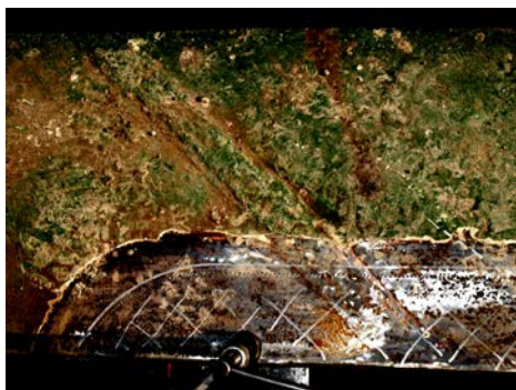
17. ábra. A főtartó felső övlemezének 45°-os gyári hegesztett illesztése (a próbavétel céljából kivágandó rész bejelölésével)
