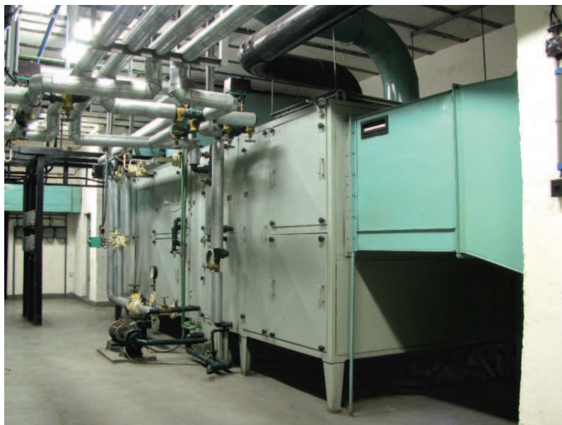
8. ÁBRA. A Prágát és környékét védő 71. légvédelmi rakétadandár Drnov melletti harcálláspontjának háromszintes létesítményében látható klímablokk a hozzacsatlakozó vízcsövekkel és légvezetékkel (A szerző felvétele)
