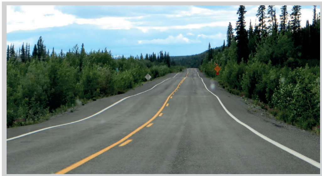
14. ábra. Műút deformálódása a permafroszt olvadása következtében Kanadában (fotó: Horváth G.)
