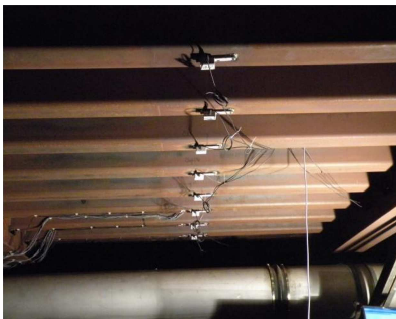
2. ábra: B-WIM szenzorok a millau-i völgyhíd ortotrop pályalemezének trapézbordáin, 2009 [8].
