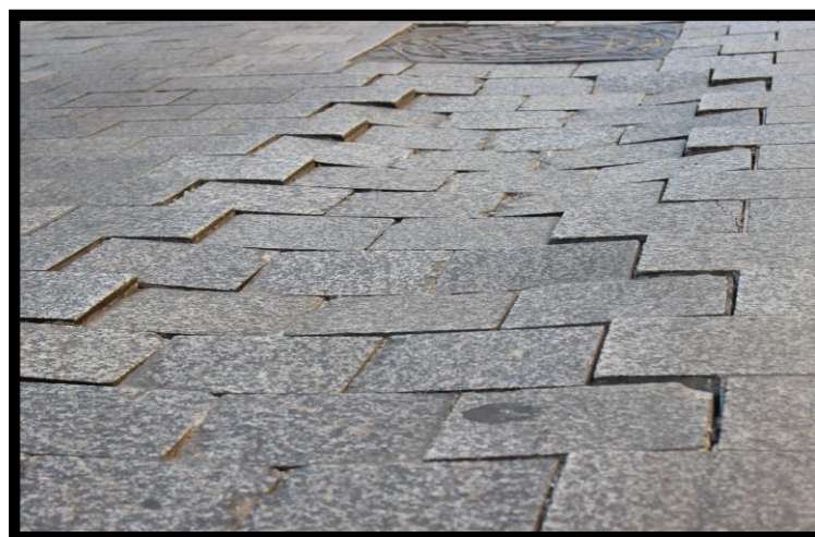
8. ábra: Térfőburkolat alatti szemcsés alaprég tönkremenetele.
