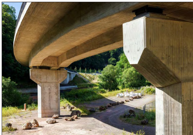
8. ábra: Utólagos betonbevonat nélküli, deszkaszalu-mintázatú híd-szerkezet (Brücken 2024: 199)
