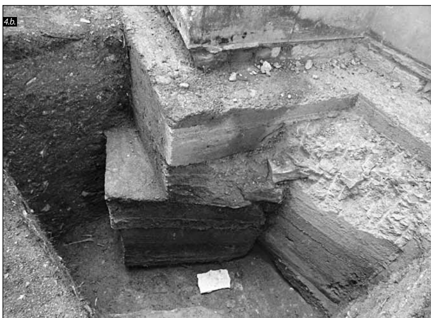
■ Foto. 4. a. Contrafortul 2 fisurat al bisericii reformate de pe strada Kogălniceanu © SC IROD M SRL, b. Sub- și juxta-turnările neomogene din anii 1960, nedocumentate, ale bisericii reformate din Sic © SC IROD M SRL
