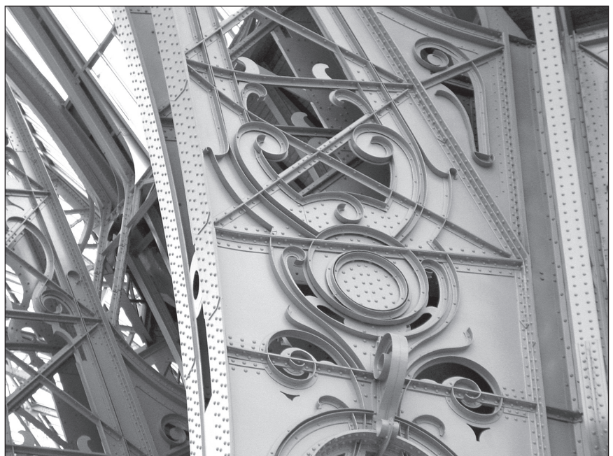
■ Foto 8. Grand Palais, Paris. Structura din fontă, evident industrială și în același timp evocând prin decorație o tradiție formală, pare o materializare a ideilor lui VIOLLET-LE-DUC, atunci când teoretizează crearea unei arhitecturi tehnice și expresiv proprii epocii moderne
