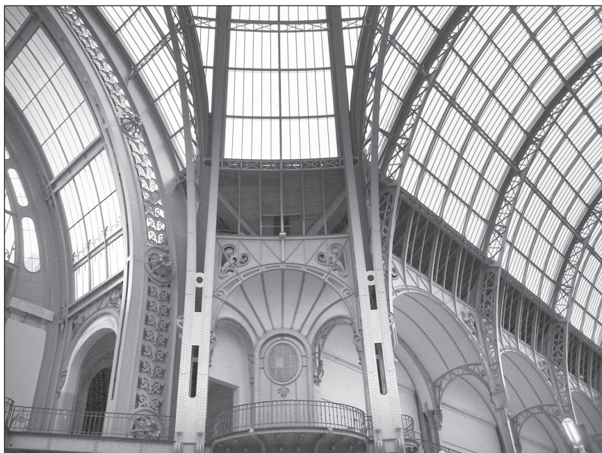
■ Foto 9. Grand Palais, Paris. Cupola de fontă și sticlă reia, în versiune mașinistă și pentru un program modern, temele clasice ale acoperirii marilor deschideri. Astfel, aplicarea de restauratori a unor detalii constructive avansate este în spiritul monumentului istoric
