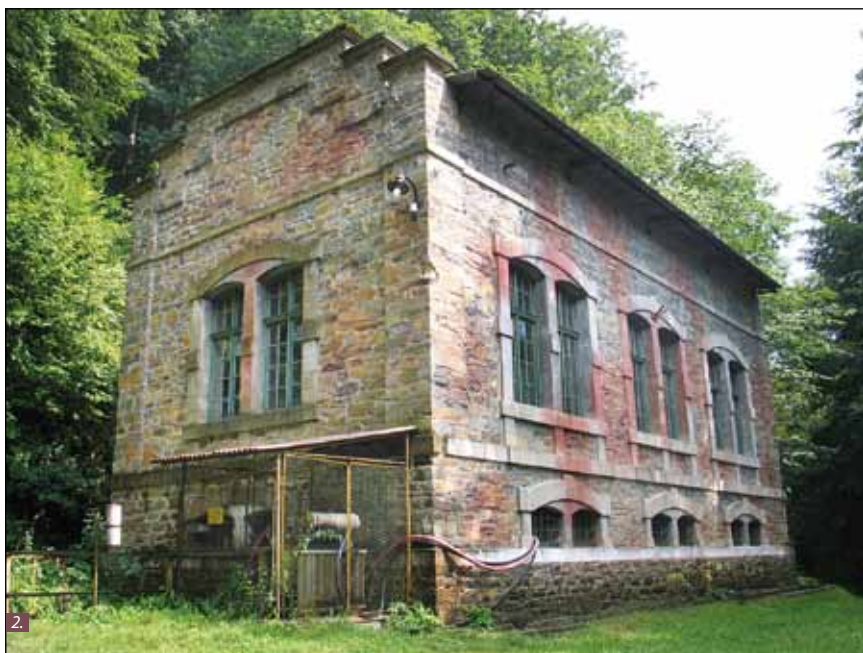
■ Foto 2., Fig. 2., Fig. 3. Centrala Hidroelectrică Breazova: fotografie și releveul fațadelor. © Echipa UAUIM în timpul campaniei de inventariere, 2004
