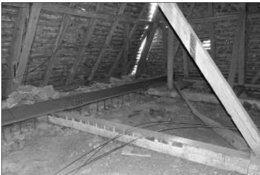
■ Foto 4. K7: învelitoare extrem de degradată, intervenții ulterioare neprofesionale, lipsă locală de rigidizare ■ Photo 4. K7: extremely decayed covering, evidence of unprofessional intervention, local lack of bracing
