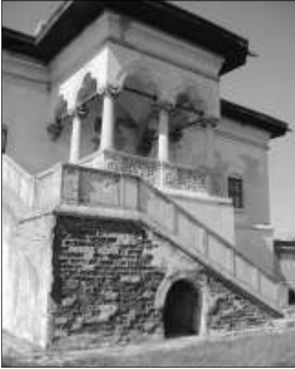
■ Foto 4. Foișorul Palatului Potlogi și efectele mortarului de ciment
