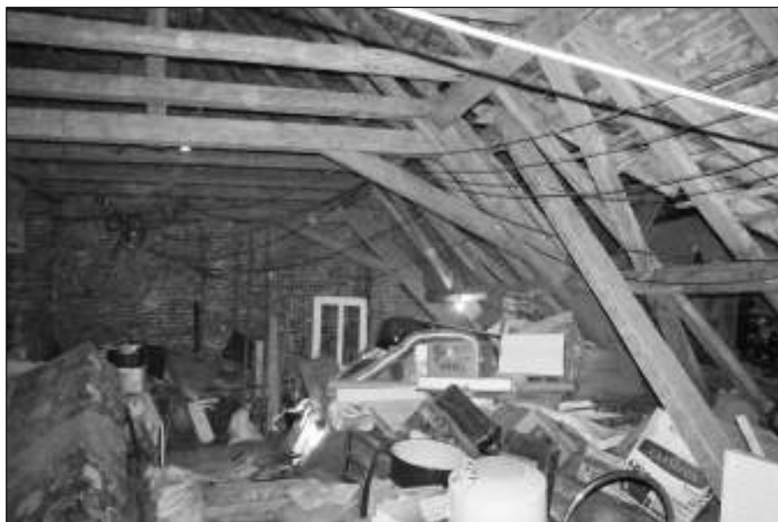
■ Foto 3. K15: utilizarea improprie ca spațiu de depozitare a podului, imposibilitatea întreținerii ■ Photo 3. K15: inappropriate use of the attic as storage, impossible to maintain
