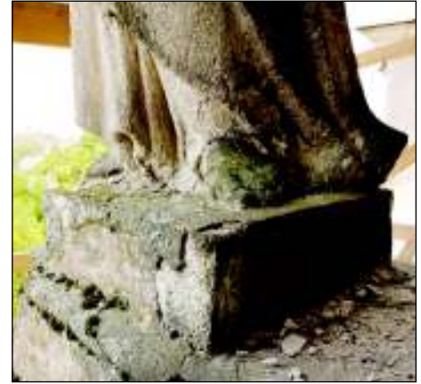
■ Foto13. Plinta a fost reparată cu tencuială neadecvată de ciment ■ Photo 13. The plinth was repaired with inadequate cement-based plastering
