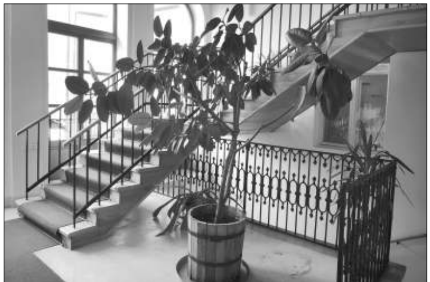
■ 11. kép: Új lépcsőfeljáró a tetőtérbe. © UTILITAS ■ Photo 11. New staircase to the attic. © UTILITAS
