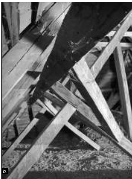
■ Foto 4. Insuficiențe de mecanica șarpantei. Probleme de realizare a îmbinărilor, care au condus la: a) deplasare de corp rigid, b) insuficiențe de rezemare. © Adrian TUDOREANU
