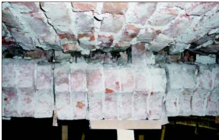
■ 7. kép: Eredeti helyéről kimozdult bordaszakasz. © UTILITAS ■ Photo 7. Rib section shifted from its original position. © UTILITAS
