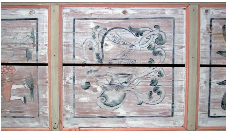
■ 15. kép: A krasznai/Crasna (Szilágy megye) református templomba a közelmúltban beszerelt padlófűtés gépészetének látványa és az új fűtés okozta repedés a templom kazettás mennyezetén.
