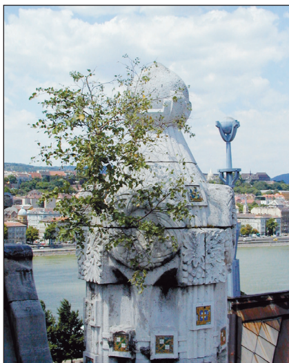
■ 7. kép: Az elhanyagolt kőhomlokzat ■ Photo 7. The neglected stone façade
