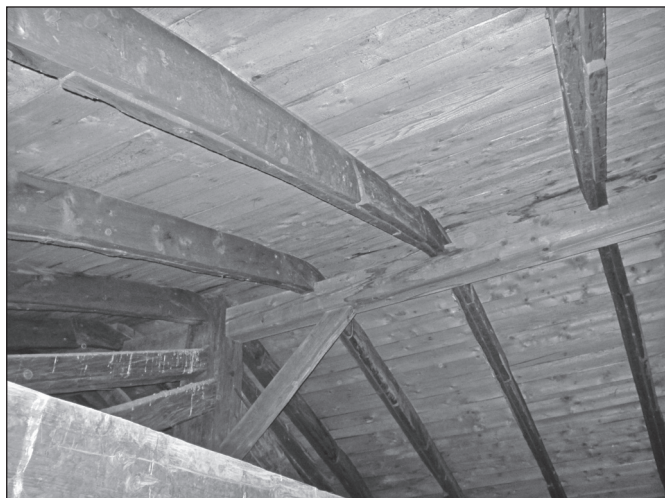
■ Foto 7. Tehnologii de excepție la subansambluri de structură portantă istorică: șarpanta Bisericii Ortodoxe din Lugoj, cu căpriori alcătuiți din perechi de dulapi
