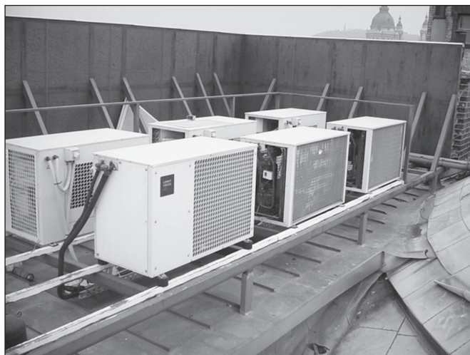
■ Foto 11. A mellvédfalak mögé helyezett kültéri klímagépek ■ Photo 11. Exterior air-conditioners concealed by parapets
