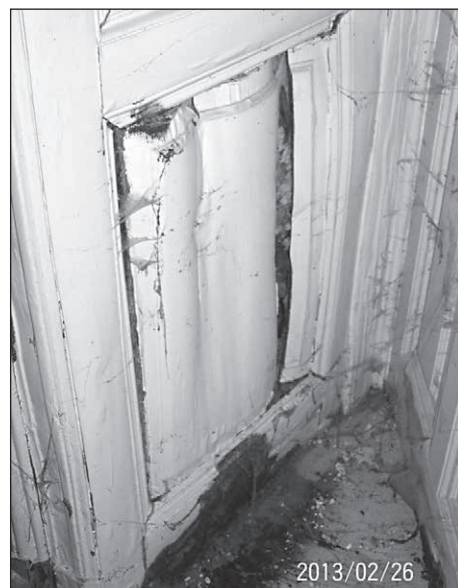
■ 14. kép: Könnyező házigomba kártétele © BÁNKY László, KIRÁLY Béla ■ Photo 14. Decay caused by dry rot © BÁNKY László, KIRÁLY Béla
