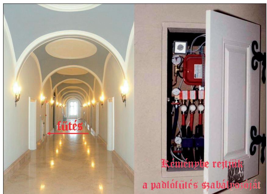
■ 1. kép: Kéménybe rejtett fűtéselosztó
