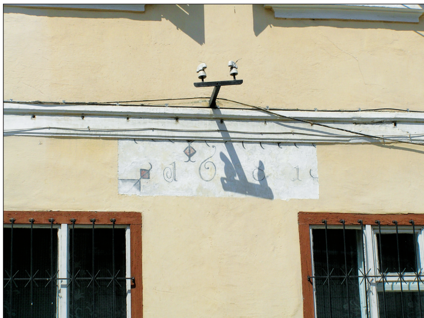
■ 14. kép: Vezetékek a homlokzaton
