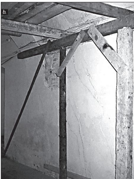
■ 2 a–b. kép: Az Erdélyi Néprajzi Múzeum feldúcolt bejárati boltozata ■ Photo 2 a–b. The choked entrance vault of the Transylvanian Museum of Ethnography in Cluj
