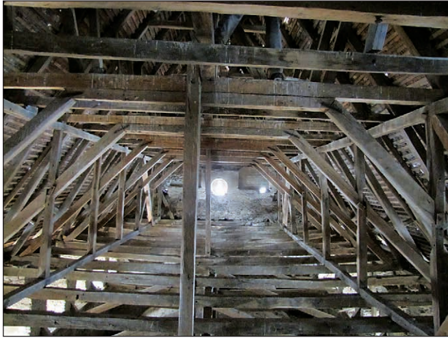
■ 12. kép: A hajó feletti fedélszék keletről (2013) ■ Photo 12. The eastern part of the roof structure above the nave (2013)
