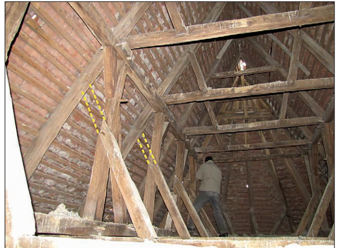
■ 9. kép: A szentély feletti fedélszék második szintje, levágott szögletkötők ■ Photo 9. The second level of the roof structure above the chancel, cut angle braces
