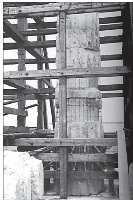
■ 6. kép: Márványoszlop kiegészítése vasbetonnal ■ Photo 6. Completion of a marble column with reinforced concrete
