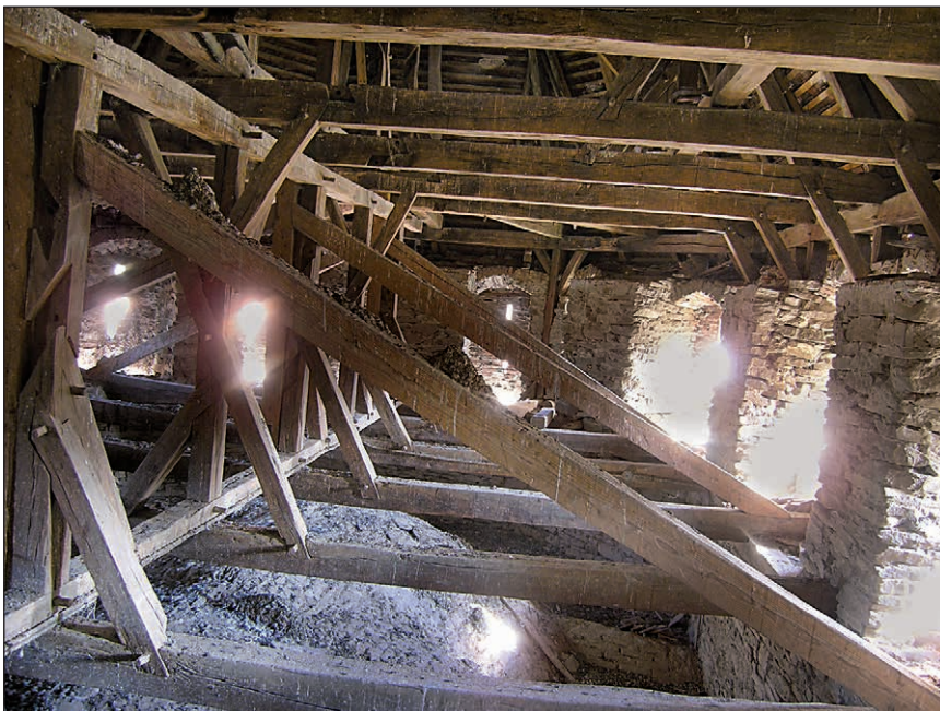
■ 10. kép: A szentély feletti fedélszerkezet védelmi szintje (2013) ■ Photo 10. The defensive level of the roof structure above the nave (2013)
