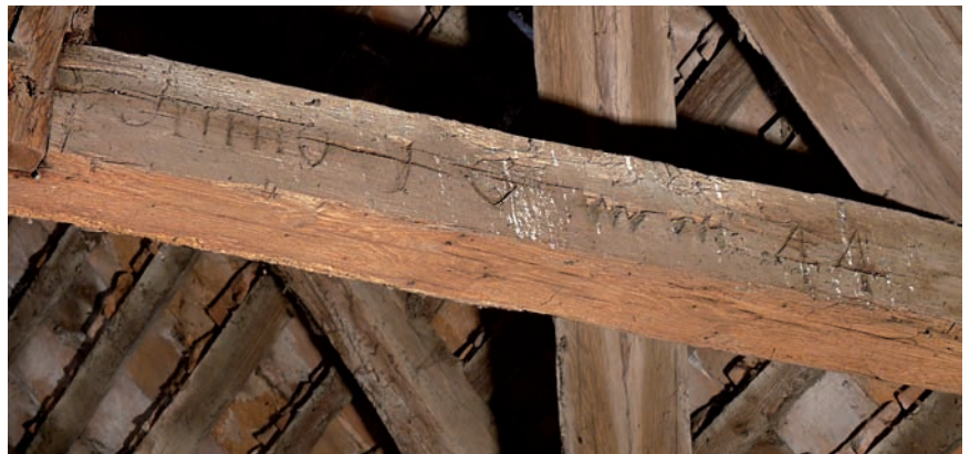
■ Foto 9. Valori de patrimoniu – inscripție pe traversa fermei IX ■ Photo 9. Heritage value – inscriptions on the collar beam of frame no. IX
