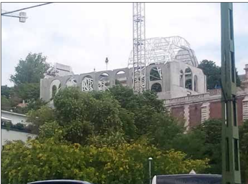
■ 13. a) kép. Budapest (Magyarország), a királyi lovarda visszaépítés közben: XXI. századi szerkezet XIX. századi formához ■ Photo 13. a) Budapest (Hungary), the Royal Riding Hall during conservation: 21 st century structure for 19 th century form
