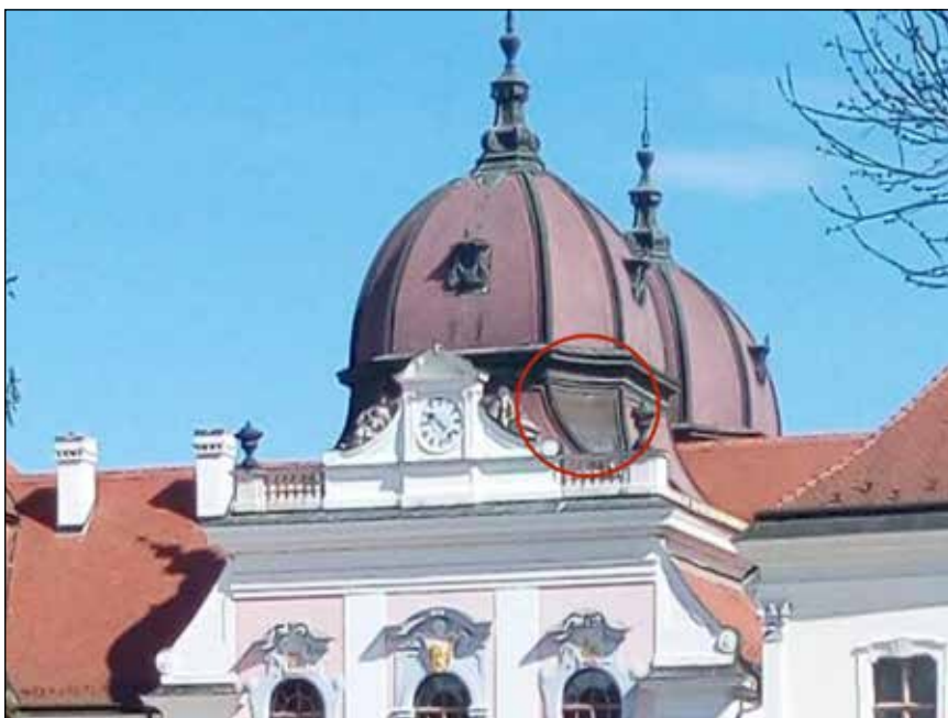
■ 5. kép. Gödöllő, kastélytető, a körrel jelzett felület fedése eredetileg is hibás volt: kétszer hajlott felületet nem lehet palával lefedni © MÁTÉ Zsolt
