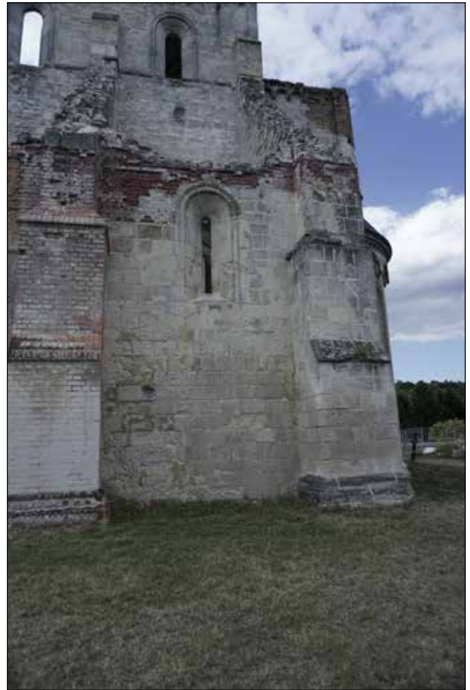
■ 4. kép: A keleti támpillér környezetének repedésképe © MEZŐS Tamás ■ Photo 4. Cracks around the eastern buttress © Tamás MEZŐS
