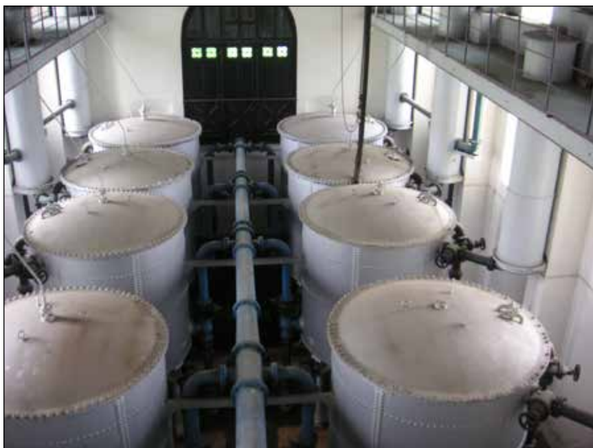
■ Foto. 8. Uzina de Apă – instalația de filtre în conservare © Liliana ROȘIU ■ Photo 8. Water Plant – filtering installation in preservation © Liliana ROȘIU
