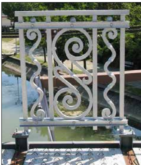
■ Foto. 13. Detaliu de balustradă reconstituită la podul „Traian” © Liliana ROȘIU ■ Photo 13. Reconstructed railing detail from the „Traian” Bridge © Liliana ROȘIU
