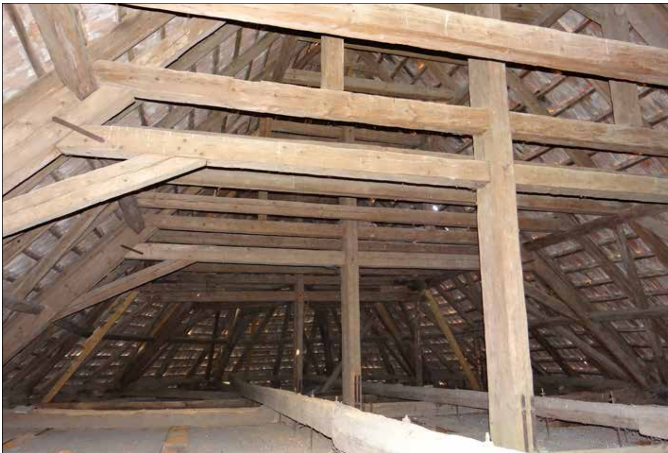
■ Foto 1c. Șarpanta (III) Bisericii Unitariene din Bădeni, jud. Cluj, înainte de intervenție ■ Photo 1c. Roof structure (III) of the Unitarian Church in Bădeni, Cluj Co., before the intervention
