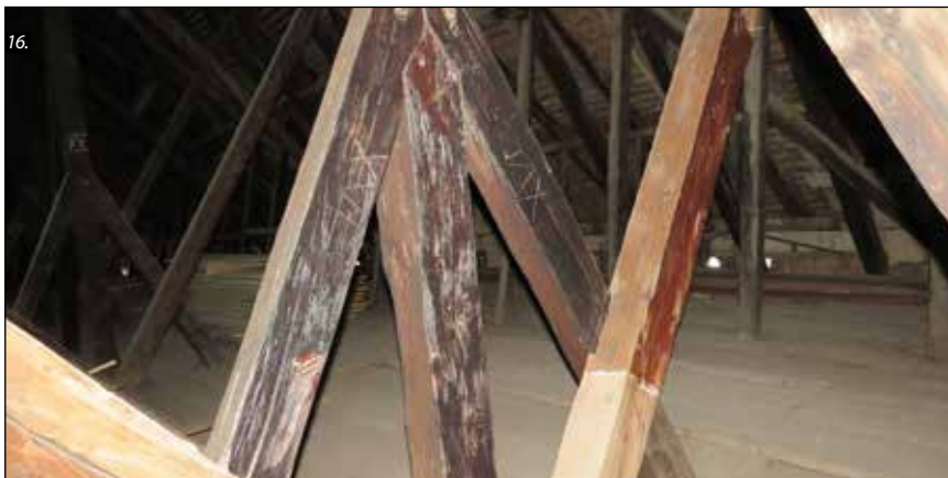
■ Foto 15. Element original, tratat cu substanță uleioasă, depuneri de praf și murdărie © Livia BUCȘA
