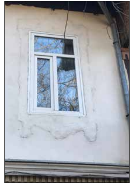
■ Foto 7. Detaliu urmă ancadrament fereastră fațadă posterioară – intervenție neconformă de tencuială cu ciment © bondstudio 2018
