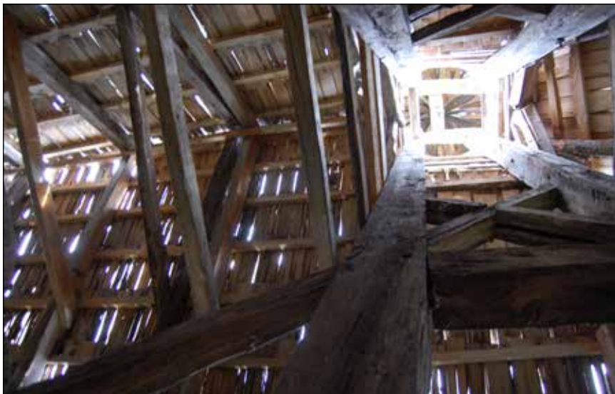
■ Foto 5. Biserica de lemn de la Dragomirești înainte de intervenția de urgență, imagine din podul bisericii, în care se vede starea de conservare a șindrilei © Diana BELCI ■ Photo 5. The wooden church in Dragomirești before the emergency intervention, photo from the church attic, showing the state of preservation of the shingle © Diana BELCI
