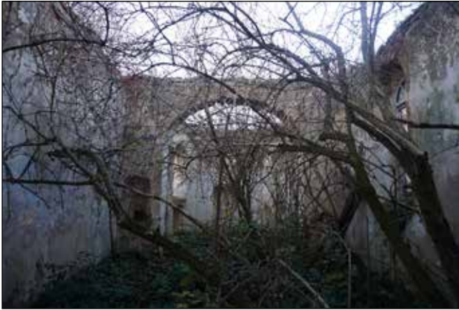
■ Foto 11. Poză interioară din capela barocă. Atât naosul, cât și altarul este invadat de vegetație, lipsa învelitoarei și umiditatea crescută au favorizat flora, 2018 © Maria Alexandra SAS ■ Photo 11. Interior view of the Baroque chapel. Both the nave and the choir have been invaded by vegetation, the lack of a roofing and the high levels of humidity have favoured flora development, 2018 © Maria Alexandra SAS
