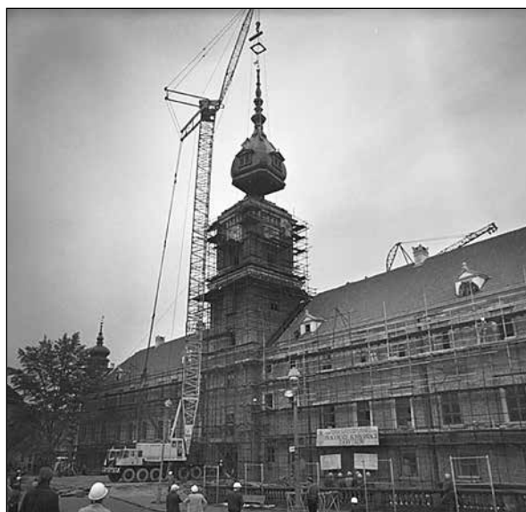
■ Photo 11. Works on the reconstruction of Warsaw Castle, 1975 © PAP/W. OCHNIO ■ Foto 11. Lucrări de reconstrucție ale Cetății Varșovia, 1975 © PAP/W. OCHNIO
