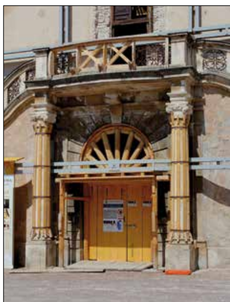
■ Photo 12. L'Aquila, Palazzo Aldringhelli, detail © Stefano D'AVINO, 2013 ■ Foto 12. L'Aquila, Palazzo Aldringhelli, detaliu © Stefano D'AVINO, 2013
