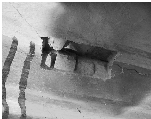
■ Foto 6. Nervuri desprinse – crăpătura și cauza: lipsa de țesere ■ Photo 6. Detached ribs – crack and its cause: no weaving
