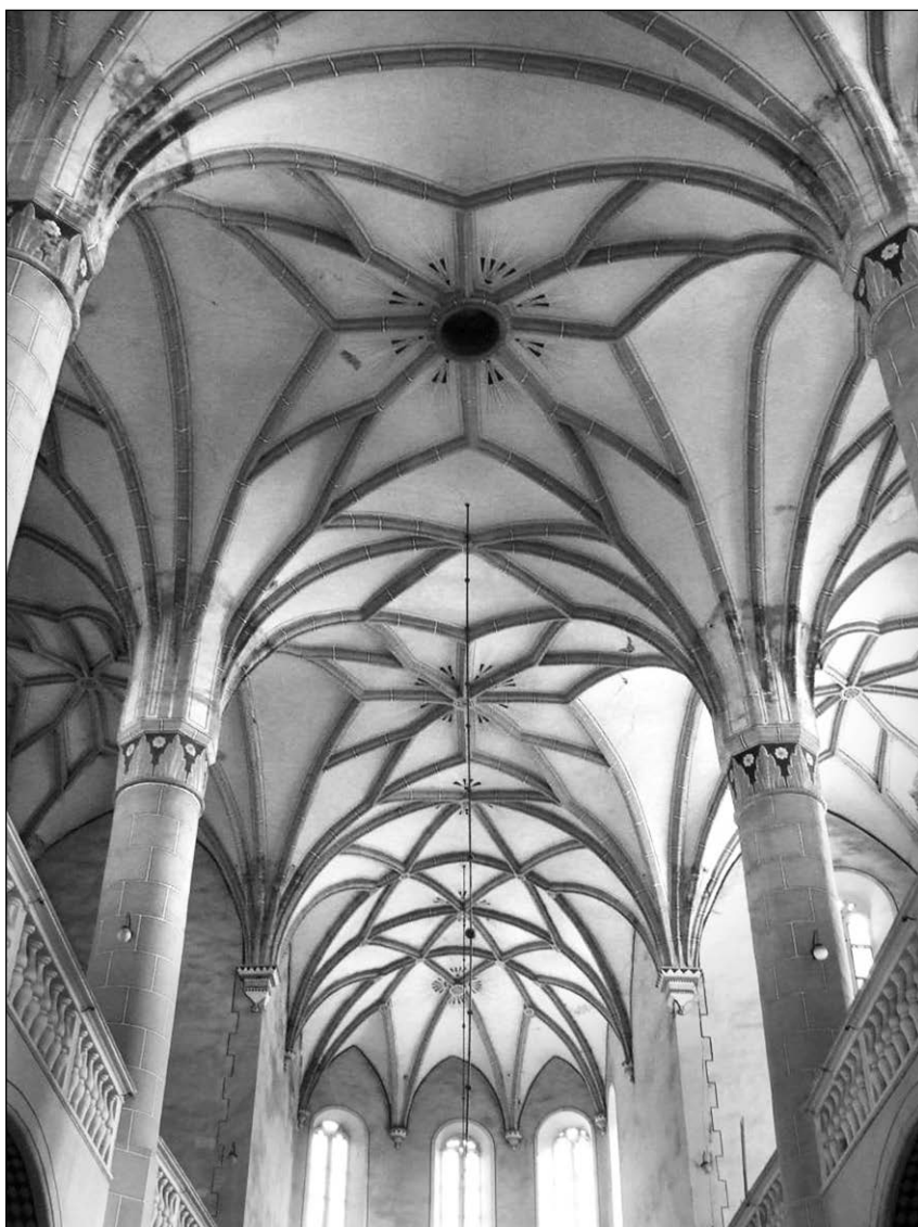
■ Foto 2. Planșeu acoperiș boltit navă și cor ■ Photo 2. The vaulted roof slab of the nave and chancel
