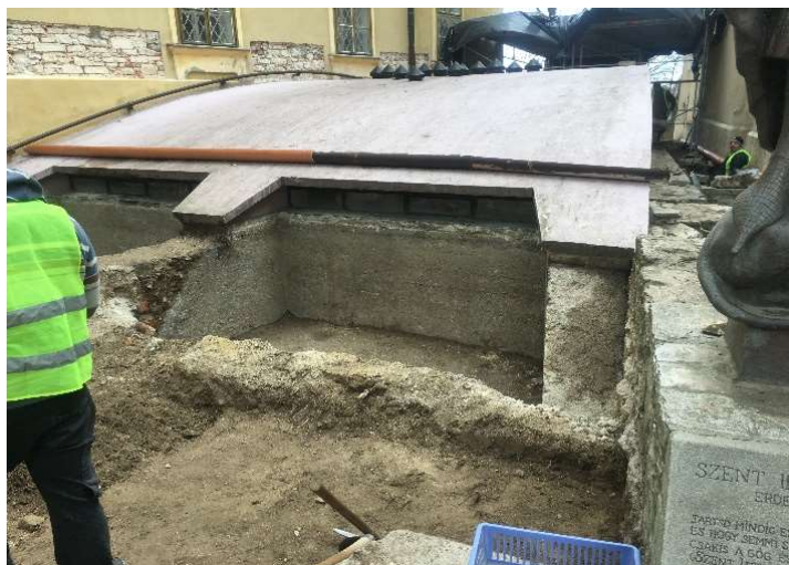
A Szent György kápolna vasbeton héjszerkezetű védőtetője a régészeti feltárás közben (fotó: Márton Annamária)
