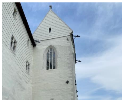
Füzeri várkápolna külső homlokzata, és az azon jelen lévő Lux Géza idején beépített vonóvasakkal
