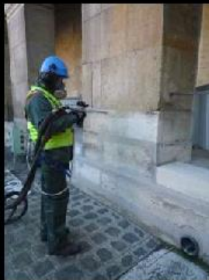
2013 HOTEL DES INVALIDES Cryogénie
