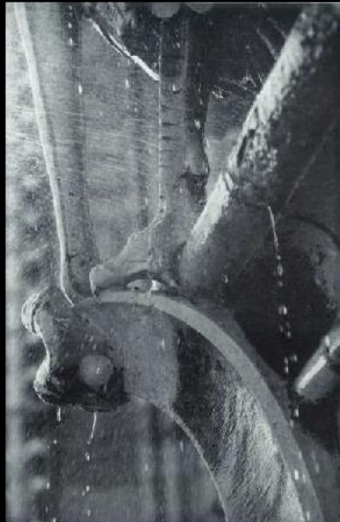
NOTRE DAME DE PARIS Lavage des parements à l'eau. Facings water washing. B. Vitry acmh
