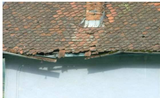
Eltömődött ereszcsonna leszakadása; Románia; Erdély, Málnásfürdő
