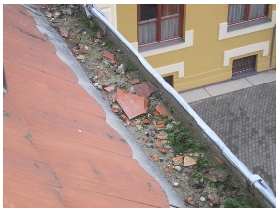
Kezdeti ereszcatorna eltömődés; Veszprém, Kossuth Lajos Általános Iskola
