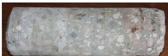
7. ábra A tűzkárosult szerkezetből vett magminta [9]
