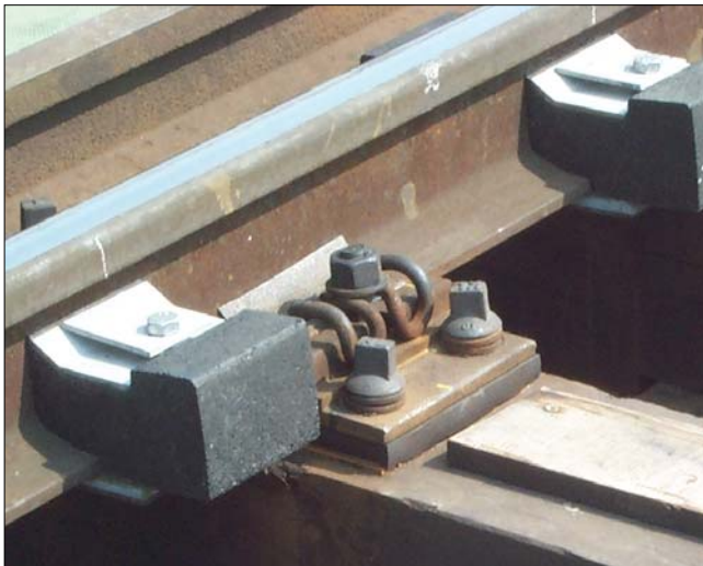
1. ábra A vasúti hídon beépített rezgésszigetelő elemek
