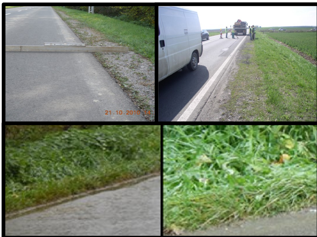
20. ábra: Burkolatszél térségi elnedvesedés valós okai.
