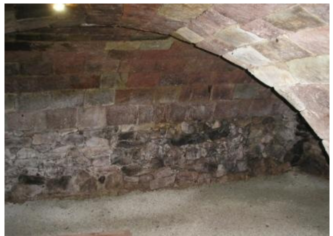
10.ábra Pótlólag aláfalazott ív Mádon
