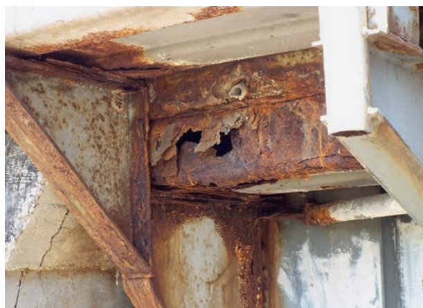
7. ÁBRA. Súlyos, lokális korrózió a sajóecsegi Sajó-hídon [17]
