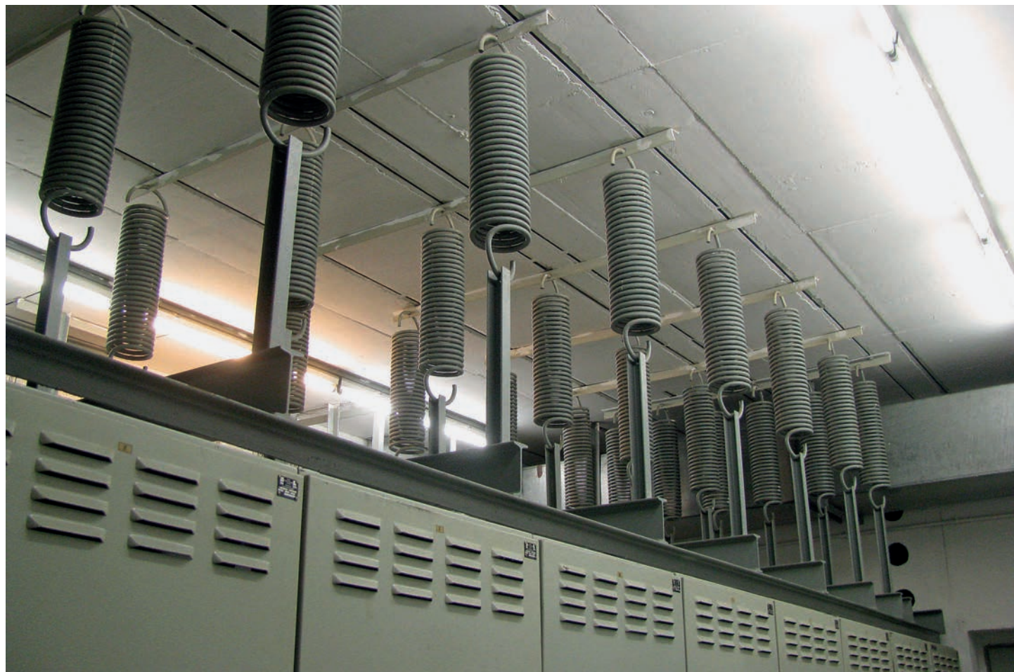
7. ÁBRA. Födémhez rögzített rugókon függő elektromos kapcsolószekrények az NDK-beli Garzauban épített bunkerben (A szerző felvétele)
