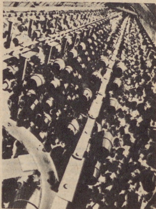
A toronyüvegház szállítóberendezése, az építmény aljáról felfelé nézve. Jól láthatók a berendezés műszaki szállító-pályái
