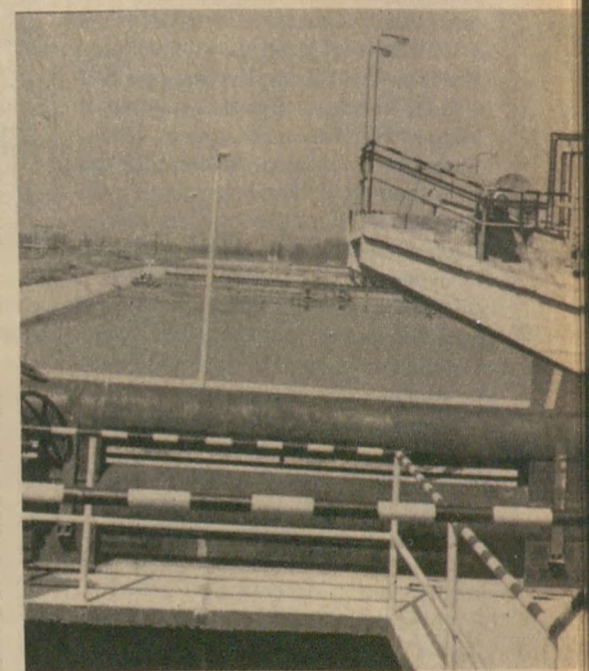
5000 köbméteres átlagositó medence az új szennyvíztisztító üzemből. A változó kémhatással érkező szennyvi- zek vegyszerelés nélküli, gazdaságos elősemlésítése, levegőztetése, átla- gosítása négy aerátorral felszerelt medencében történik
