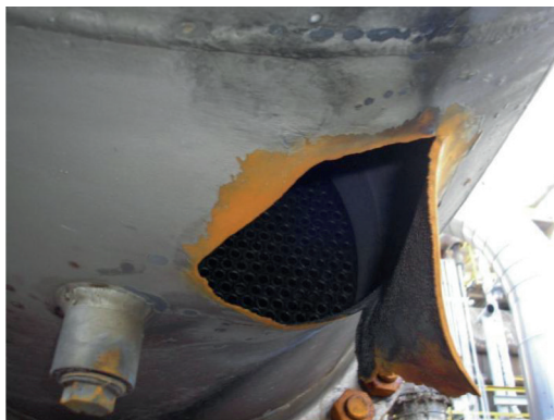
1. fénykép – A súlyos baleseti eseményt kiváltó sérült berendezéselem [11]
